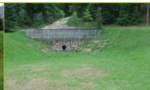
Bacino d'infiltrazione a Pianizza di Sopra, Caldaro
